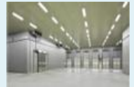
コールドチェーン確保のための冷蔵設備
